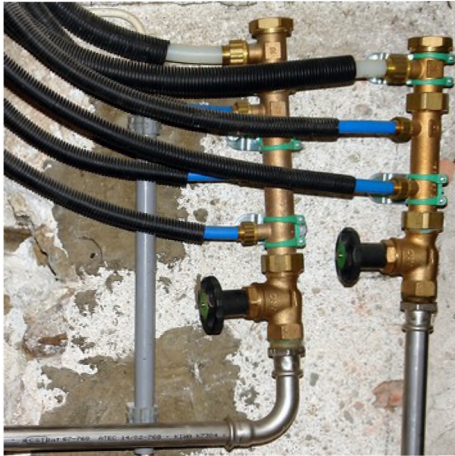
Isolazione termica carente
